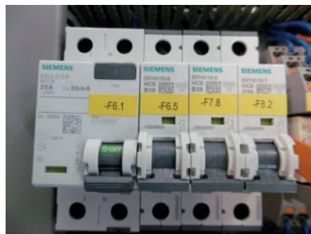
Abb. 6.7: v.l.n.r. F6.1, F6.5, F7.8 und F8.2 Schutzschalter
