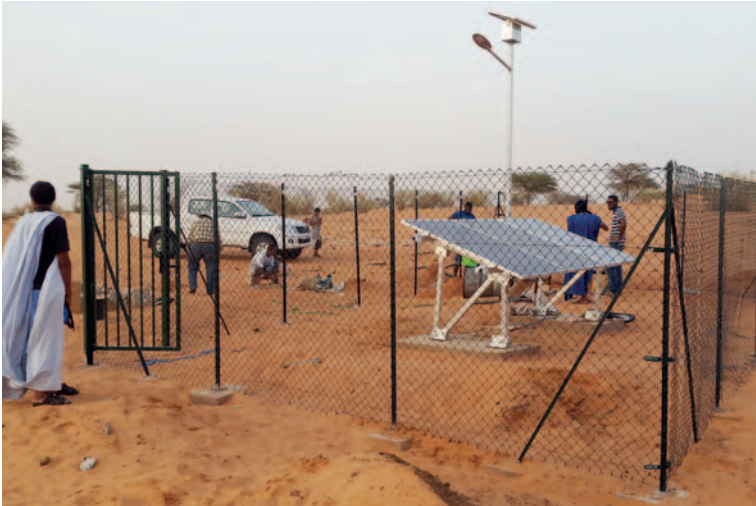
Fertiggestellte Anlage. Die Solarelemente sind angeschlossen. Die SQFLEX ist abgesenkt. Die Anlage ist betriebsbereit.
